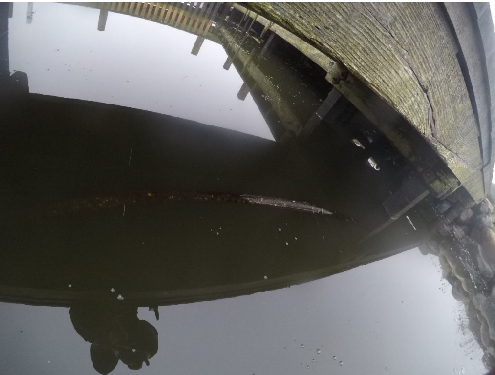
Figur 2 - Slange fra bobleanlæg ligger i overfladen ved lille bro øst for Bro 7.
