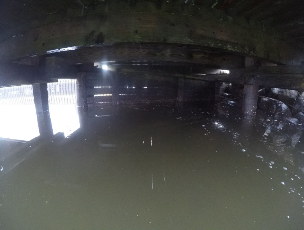
Figur 1 - Bølgevæg under mellembro sidder løst og bør renoveres.
